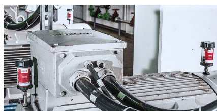
Lubricación de motor eléctrico
