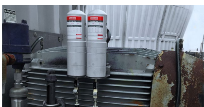
Lubricación de motor eléctrico
