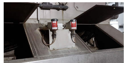
Lubrificação do rolamento no densificador de excesso de lodo
